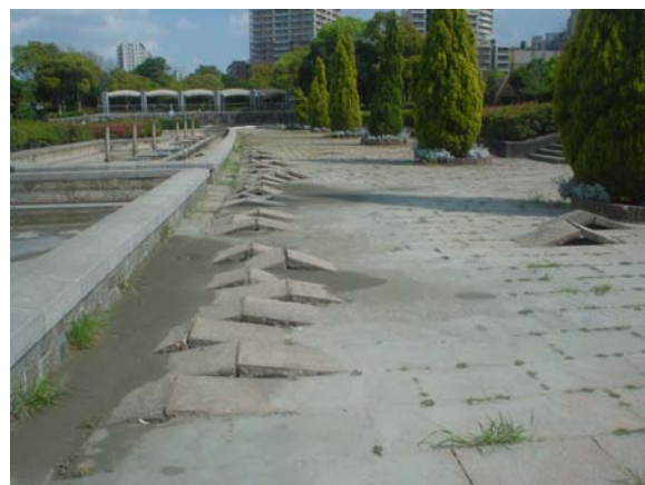
写真1. 噴砂により破壊された公園
